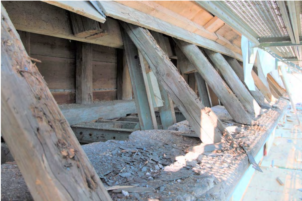
Die Traufe vom nördlichen Unterdach nach der Freilegung, nach Westen; auch hier ein dramatisches Schadensbild und erhebliche statische Unzulänglichkeiten; sämtliche Hölzer im Dachfußbereich wurden im Zuge früherer Sanierungsmaßnahmen entfernt und durch eine Stahlkonstruktion aus verschweißten U-Schienen ersetzt, Juli 2019.
