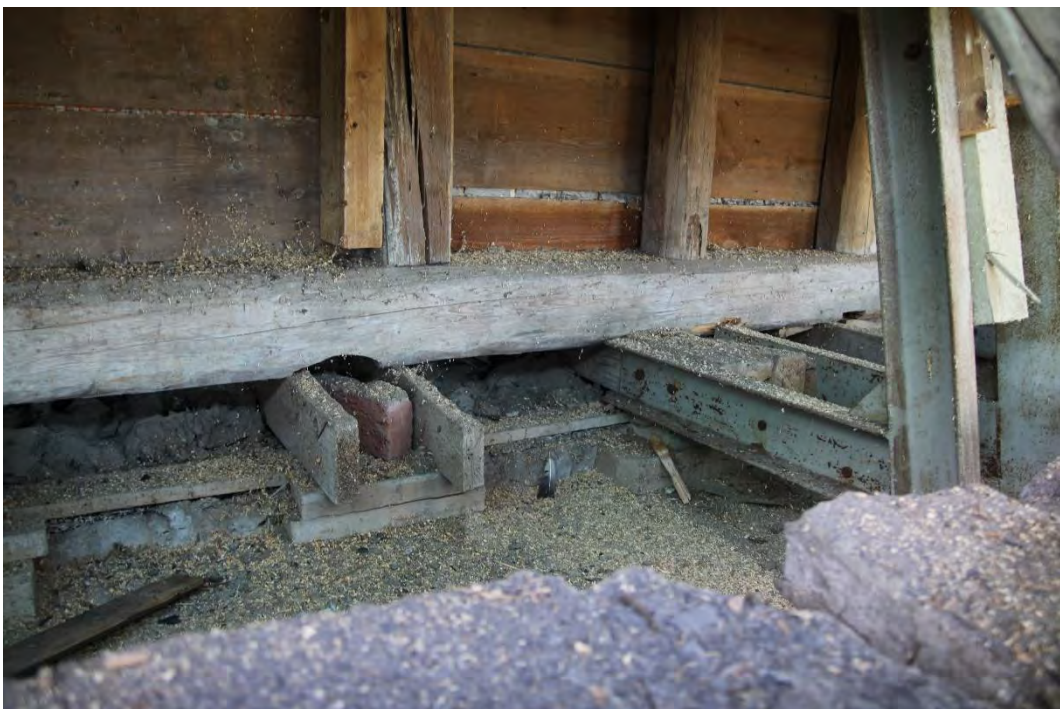
Traufe nördliches Unterdach; fehlender Balkenkopf, die Verbindung der U-Eisen bzw. Anlaschung mit den verbleibenden Restbalken ist insgesamt zu kurz ausgeführt und nur mit Schlüsselschrauben gesichert, Juli 2019.
