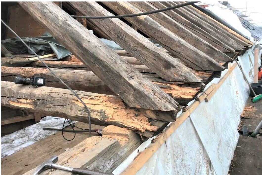
Freigelegter Traufbereich vom nördlichen Unterdach, nach Westen, auch hier schwere Fäulnisschäden an den Balkenköpfen, Juli 2019.
