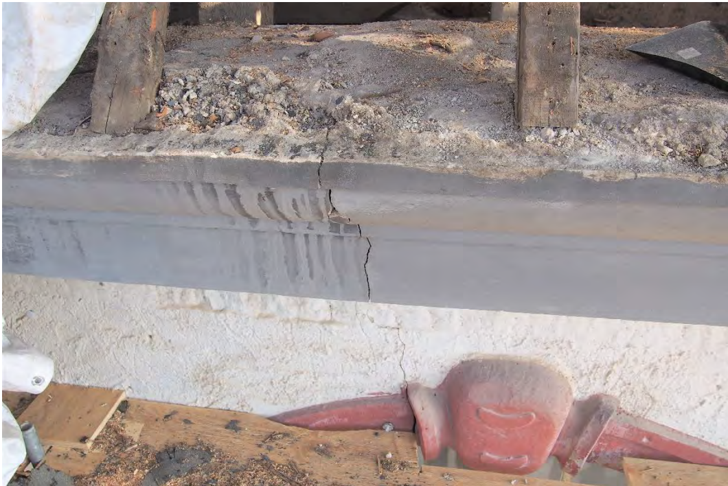
Südliches Hauptgesims vom Kirchenschiff; an dem ca. 50cm auskragenden steinernen Hauptgesims sind Verformungen und Rissbilder erkennbar, zur Vermeidung eines Absturzes besteht hier dringender Handlungsbedarf, April 2019.
