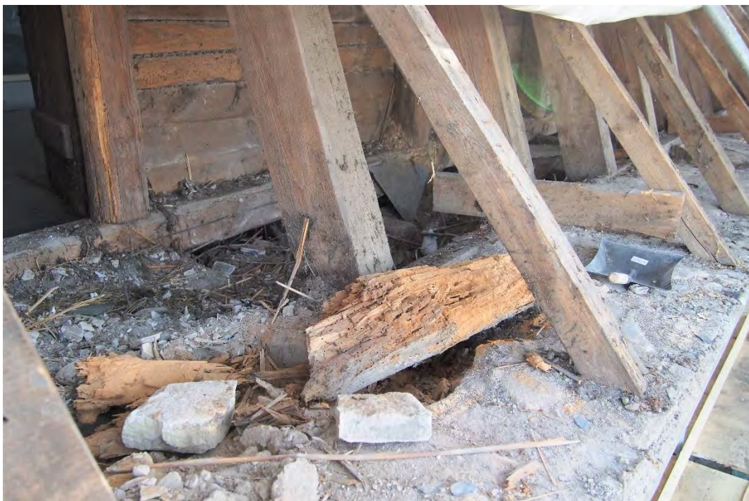
Traufe südliches Unterdach – westlicher Bereich; Schwammbefall und völlig vermoderter Mauerbalken, April 2019.
