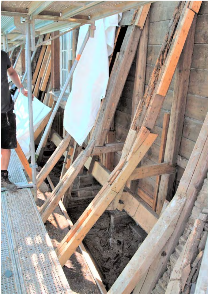
Aufgehende Dachkonstruktion vom nördlichen Unterdach, nach Osten; schwere Fäunisschäden an den Sparren mit Bretterlaschen im Zuge früherer Sicherungsmaßnahmen notgesichert, aufgenommen im Juli 2019.
