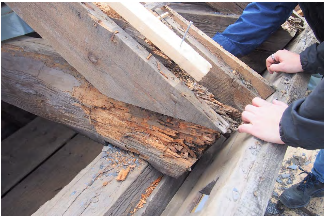
Freigelegte Dachtraufe südliches Oberdach; durch Braunfäule völlig aufgelöster Balkenkopf und Sparrenfuß, mit Laschen notgesichert, April 2019.
