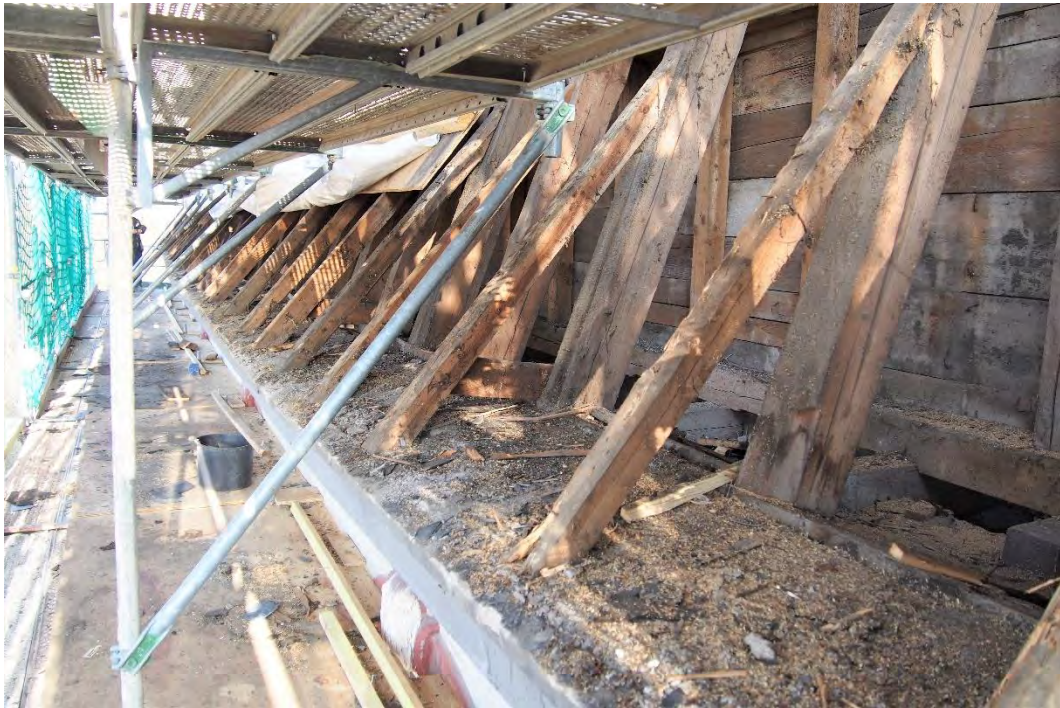
Der Dachfußbereich vom südlichen Unterdach nach der Abnahme der Schieferdeckung und Vollholzschalung, nach Westen; der gesamte Mauerkronenbereich ist stark verschuttet; ausbeulendes und abgängiges steinernes Hauptgesims; das genaue Schadensbild war erst nach der Beräumung erkennbar, April 2019.
