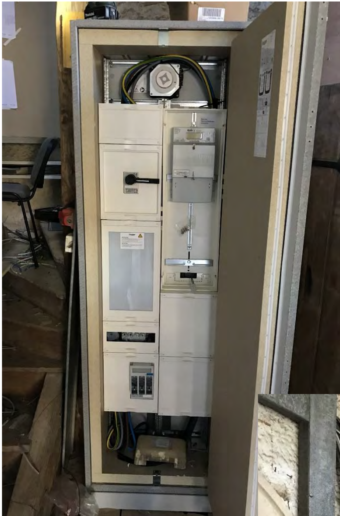
Erdgeschoss nördlicher Turmanbau, fertig montierter E-Hausanschluss bzw. Wandlermesser im Brandschutz- kasten, Oktober 2024.
