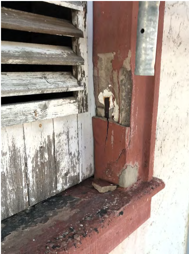
Turmnordwand, westliches Gewände Schallöffnung; Detailaufnahme korrodierte Eisenklobe und Folgeschäden, Februar 2024.
