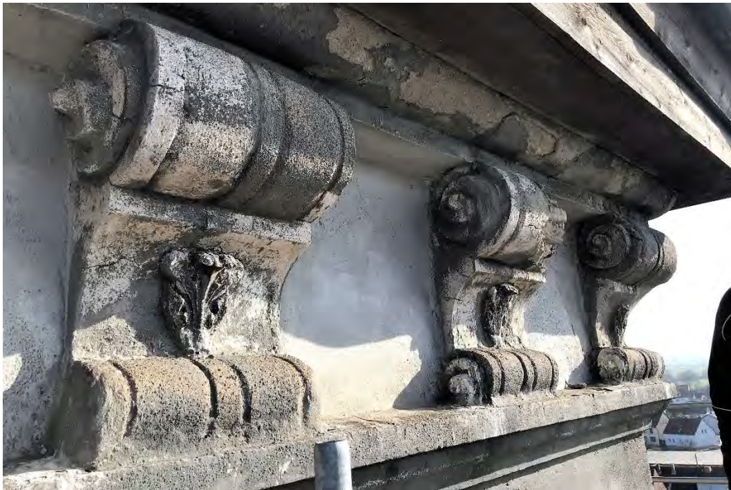
Westliches Hauptgesims nach Süden, die Stuckkonsolen sind durch Abplatzungen infolge korrodierter Eisen, Risse und zementhaltige Altmörtelantragungen geschädigt, Februar 2024.
