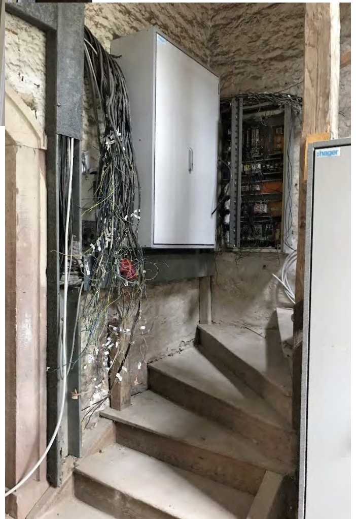
Die neue E-Hauptverteilung während der Verdrahtung, Oktober 2024.
