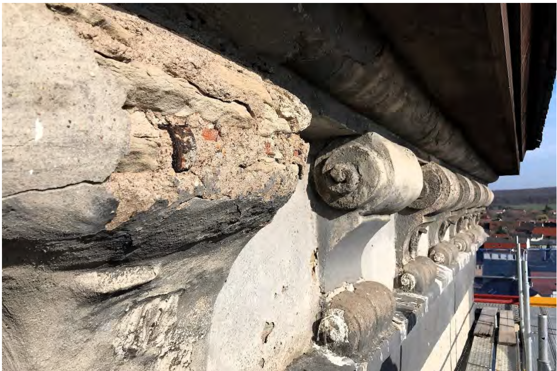
Südliches Hauptgesims, nach Osten, Detailaufnahme geschädigte Stuckkonsole, Februar 2024.
