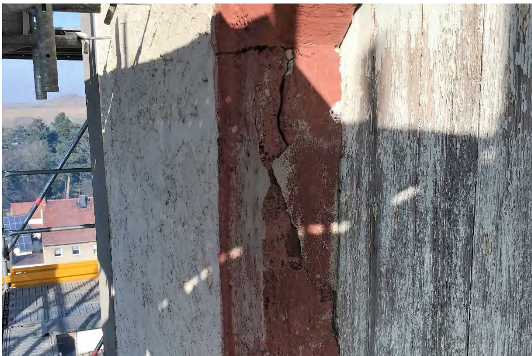
Turmwestwand, nördliches Gewände Schallöffnung, nach Norden; infolge stark korrodierter Eiskloben gerissener, absturzgefährdeter Sandstein, Februar 2024.
