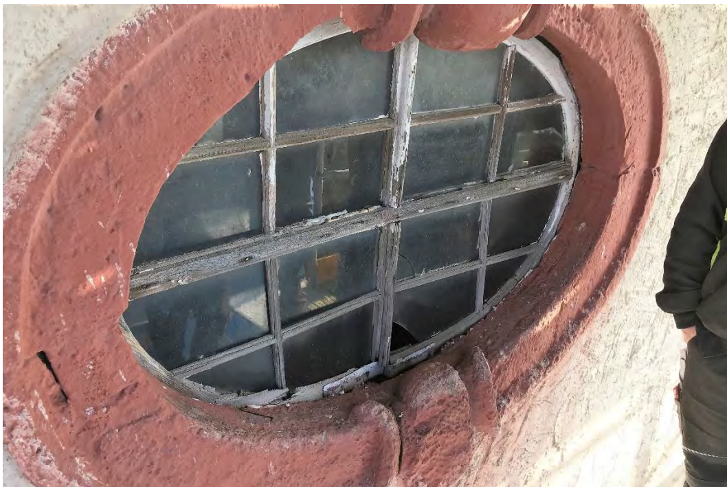
Oberes Ochsenauge Turmwestwand, durch Fäulnis irreparabel geschädigtes Holz- sprossenfenster und Schäden durch Rückwitterungen am Sandsteingewände, Februar 2024.
