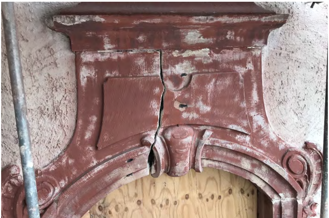
Türsturz über dem nördlichen Haupteingang nach der Reinigung, durchgehender statisch-konstruktiver Riss, April 202
