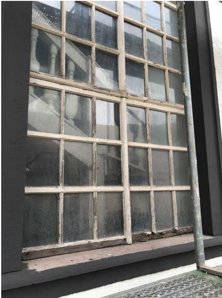
Das obere östliche Fenster in der Nordwand des Langhauses, schwere Fäulnisschäden am Holz, April 2025.
