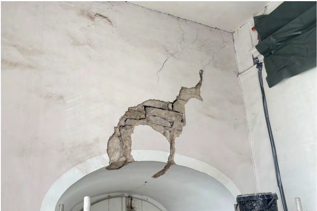
Langhaus 1. Empore, Sturz Zugang zum südlichen Treppenturm, freigelegte Rissbilder, aufgenommen im April 2026.
