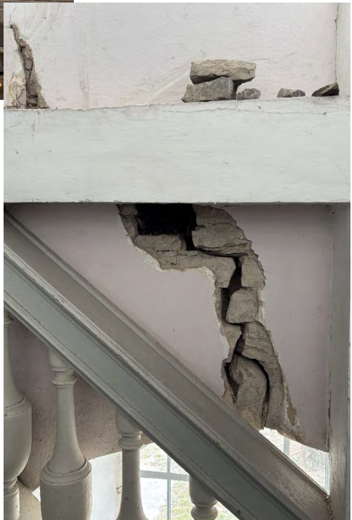
Statisch-konstruktiver Mauerwerksriss im Sturz des östlichen unteren Fensters in der Südwand des Langhauses, nach der Putzabnahme im Rissbereich, März 2026.
