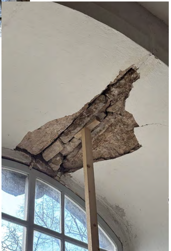
Südwand Langhaus, Sturz mittleres Fenster 1.OG, hier drohten nach der Putzabnahme die Steine herauszufallen, März 2026.
