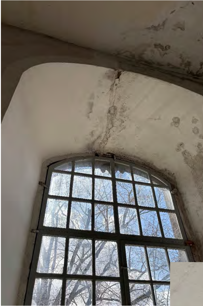
Südwand Langhaus, Sturz zweites Fenster 1.OG von Osten; Riss vor der Freilegung, März 2026.
