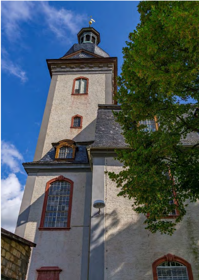
Der südliche Anbau nach Norden; abgängige Schieferplatten und undichte Gaubenkehlen, Juli 2018.
