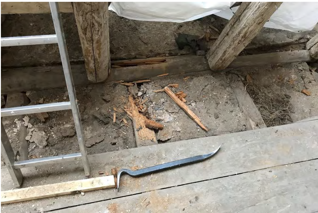
Nördliche Mauerkrone vom nördlichen Turmanbau, nach Norden; auch hier Fäulnisschäden bis zur Auflösung der Hölzer, Schwammmyzel in der Nordostecke, November 2021.
