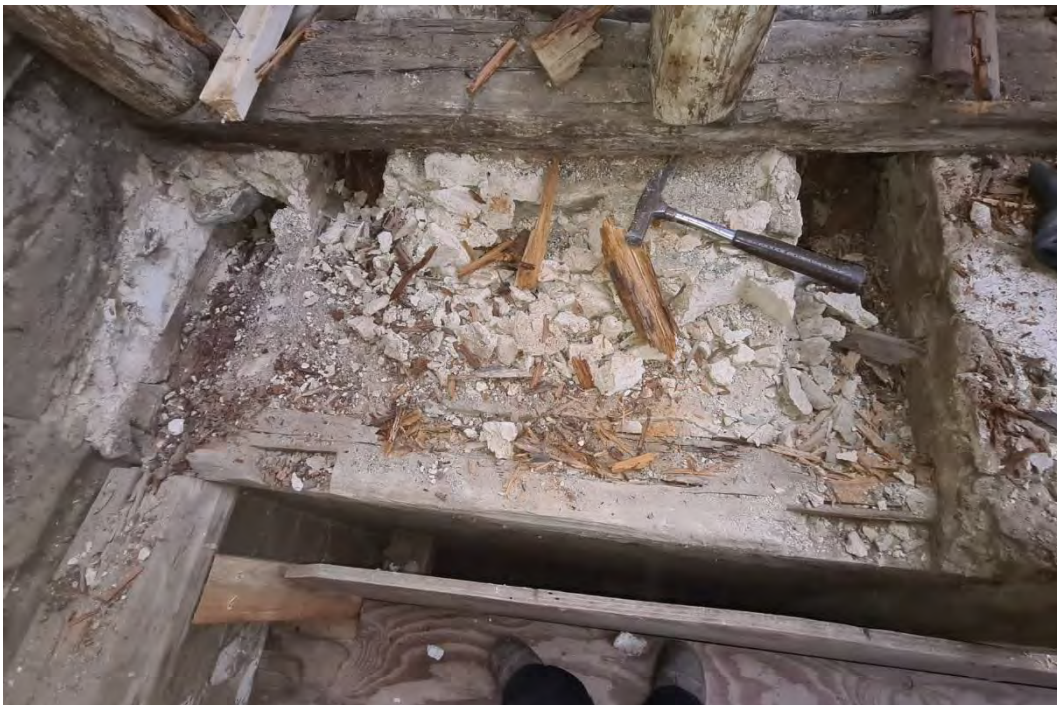
Nördlicher Turmanbau, Detail westliche Mauerkrone; durch Moderfäulnis völlig aufgelöste Stichbalken, November 2021.
