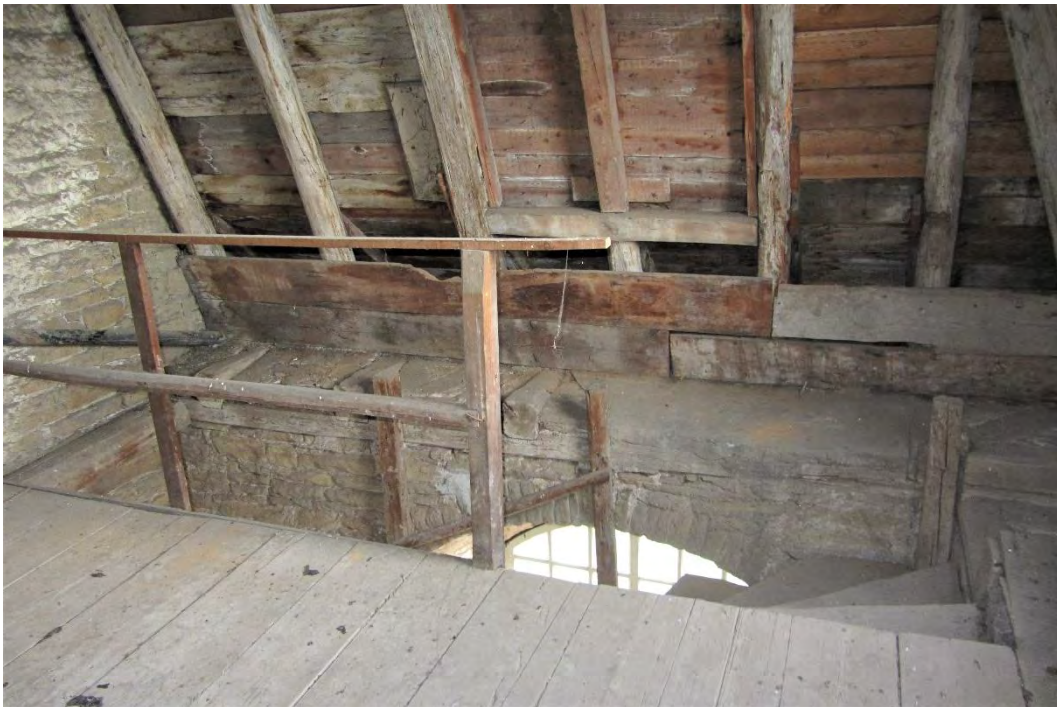
Der Dachraum vom nördlichen Anbau nach Norden; Schäden am Dachtragwerk, der Traufbereich ist nicht einsehbar, Juli 2018.
